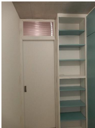
間仕切り用に新設した扉と本棚とクツゼット
